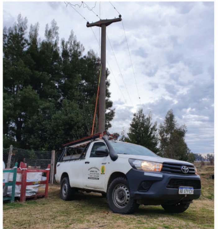
📷 Luego de 50 min. se pudo restablecer el servicio en la zona afectada.
